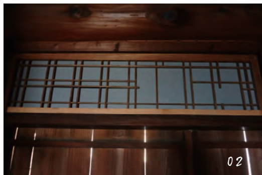
既存の欄間 (組子の部分が損傷している)
