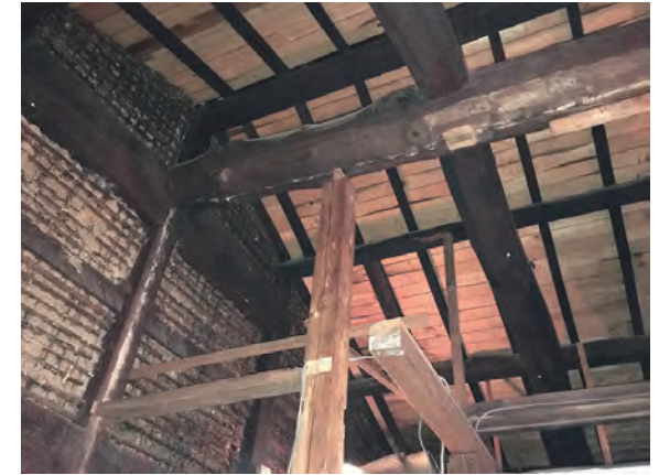
不安定な柱と梁
